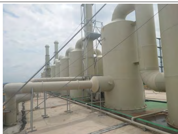
废气处理设施
